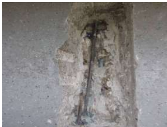
Afbeelding 4.4: Destructief onderzoek. Wapeningsstaaf verwijderd.
