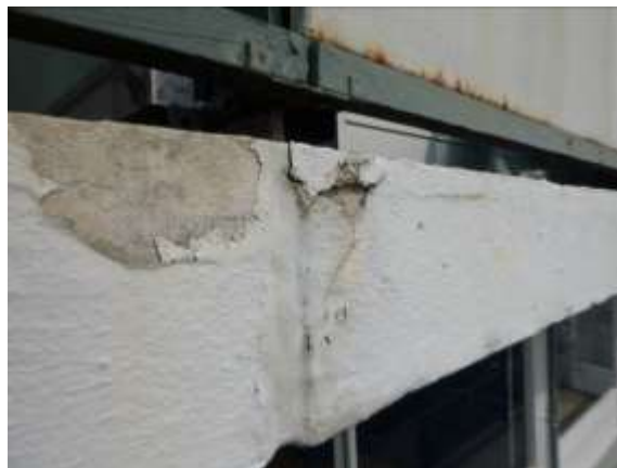
Afbeelding 4.8: Losliggend/afgedrukte betondelen aan dikkant balkonplaat.
