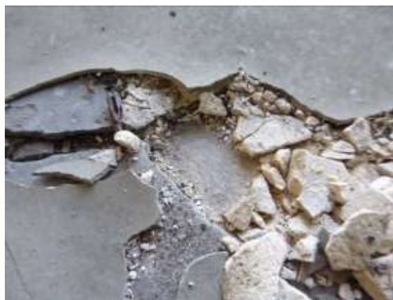
Afbeelding 4.10: Losliggende/kapotte dekvloer op balkonvloer.
