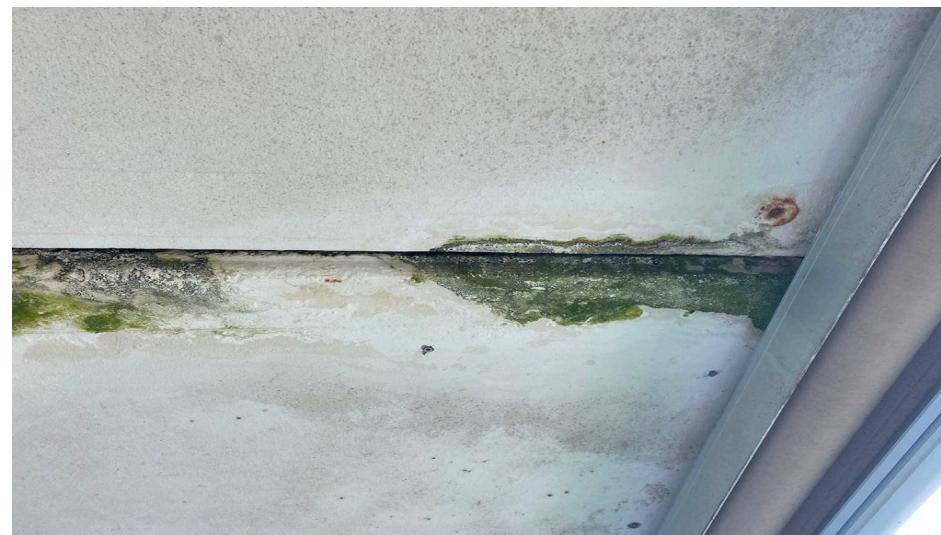
Foto 4 - Lekkage sporen aan de onderzijde van de constructie ter hoogte van de plaatnaden. Door langdurig vochtig blijven van de ondergrond begint deze door groei van algen groen uit te slaan.
