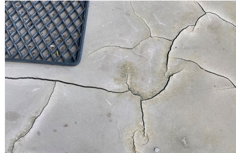
Foto 11 - Scheuren in de bestaande dikkere afdichting waardoor er inwatering plaatsvind en aan de onderzijde diverse lekkage sporen en schades zichtbaar zijn.
