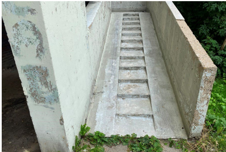
Foto 10 - Sterk verouderde trap die toegang biedt aan het complex waarvan het beton begint uit te wassen.
