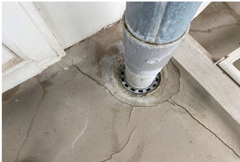
Foto 6 - Willekeurige scheuren in de bestaande afwerking waardoor er inwatering kan plaatsvinden en de constructie aangetast kan worden.
