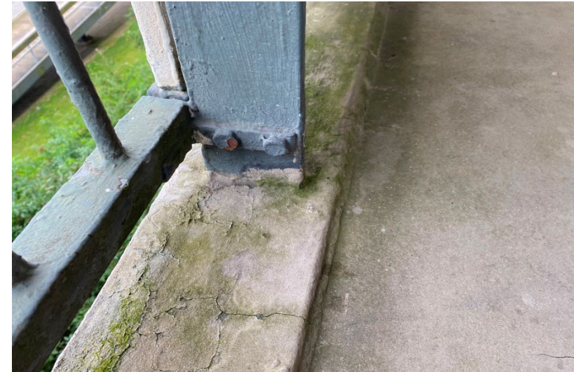
Foto 7 - Betonnen schrobrand aan de buitenzijde van de balkons met daarop een stalen hekwerk bevestigd. Ook op deze rand begint de bestaande afwerking te onthechten.
