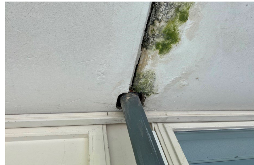
Foto 8 - Lekkage sporen aan de onderzijde van de constructie ter hoogte van de dilataties door het ontbreken van een gedegen waterdichting aan de bovenzijde.
