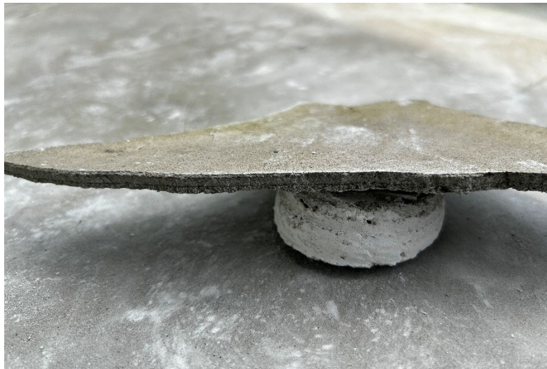
Foto 16 – Technisch Onderzoek – Uitgekomen kern zandcementafschotlaag met de bestaande afwerking die grotendeels losligt of zelfs niet meer aanwezig is.
