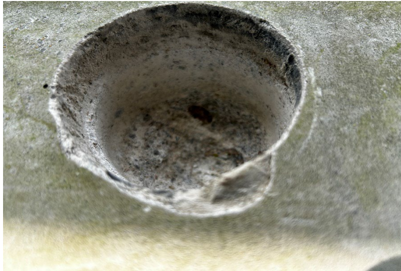
Foto 15 – Technisch Onderzoek – Kernboring gezet nabij de schrobrand aan de buitenzijde van het balkon.
