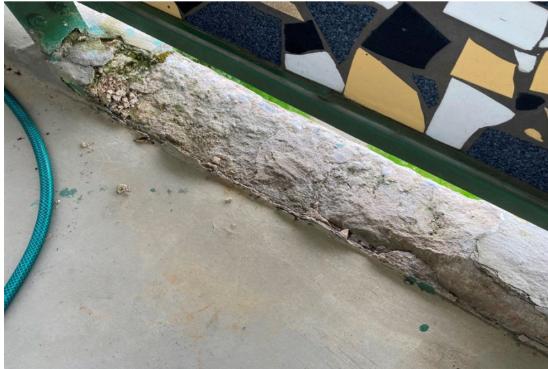
Foto 9 - Betonschade aan de schrobrand waar een groot deel van de rand verdwenen is.
