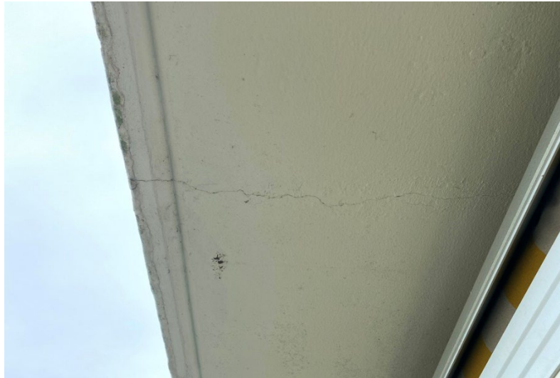
Foto 5 - Scheuren in de onderzijde van de constructie die zich haaks op de gevel uiten.
