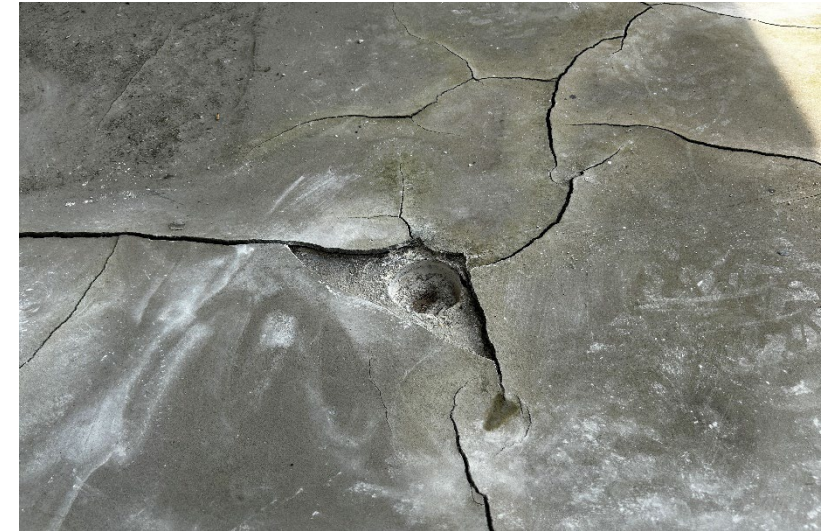
Foto 17 – Technisch Onderzoek – Kernboring gezet te midden van enkele scheuren om te onderzoek of de scheuren door en door aanwezig zijn.
