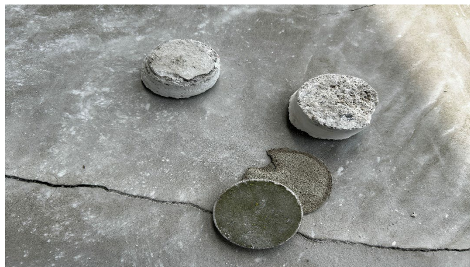
Foto 14 – Technisch Onderzoek – Uitgekomen kernen waaruit blijkt dat er een zandcementafschotlaag aanwezig is.
